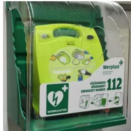
Kuva 5a – sydäniskuri seinällä
